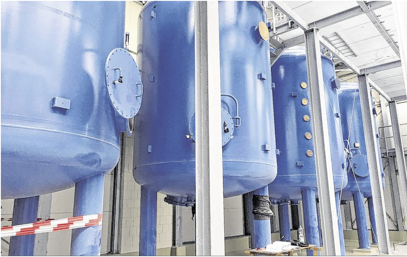
Das gesamte im Rheiderland geförderte Rohwasser wird künftig in acht solcher Kessel gefiltert und so von möglichen Schadstoffen befreit. Die Anlage geht voraussichtlich im Sommer in Betrieb. BILD: GETTKOWSKI
